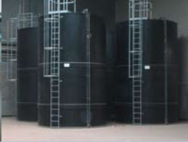
Vier Pufferspeicher je 50 m 3
